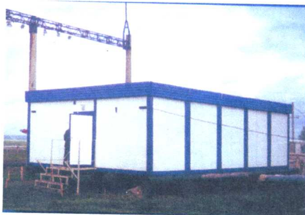
КРУ 6 кВ (вид снаружи)
