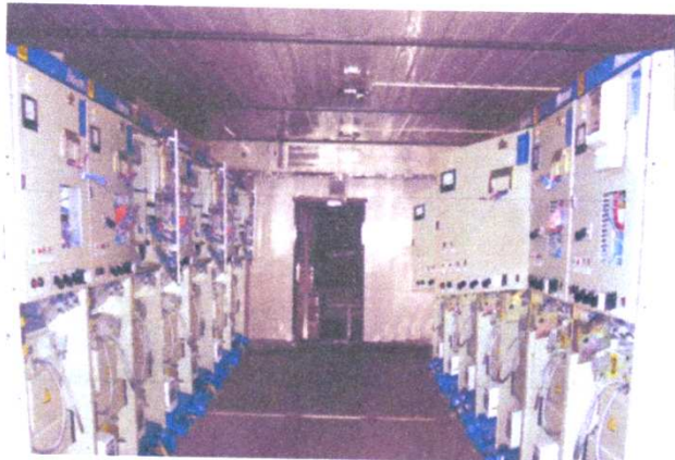
КРУ 6 кВ (вид изнутри)
