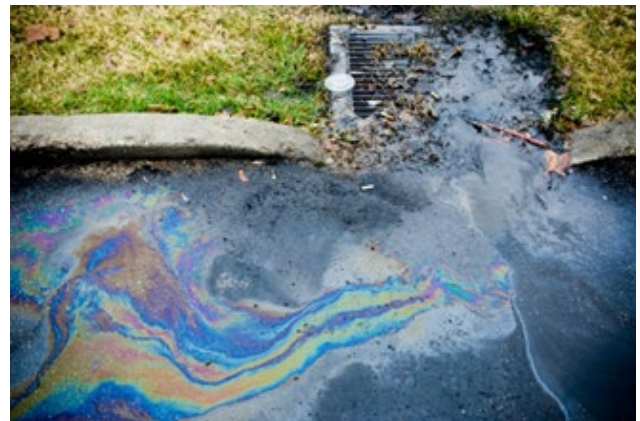
Рисунок 2. Загрязнение канализационных стоков
